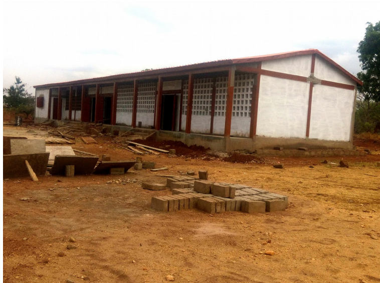
... et la nouvelle école, construite par les villageois soutenus par Action Sud
